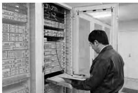
システム保守点検作業
