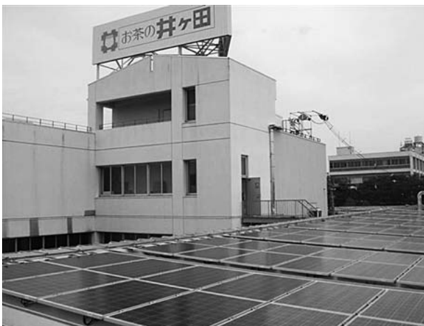
屋上に設置された太陽光発電設備
