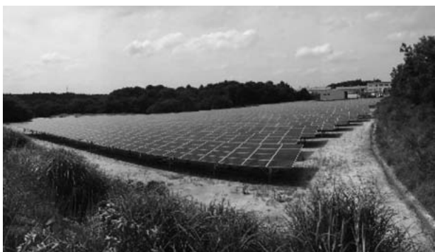
加美町にある孫沢発電所
