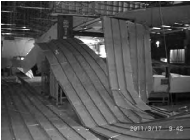
若柳工場 震災後の様子
